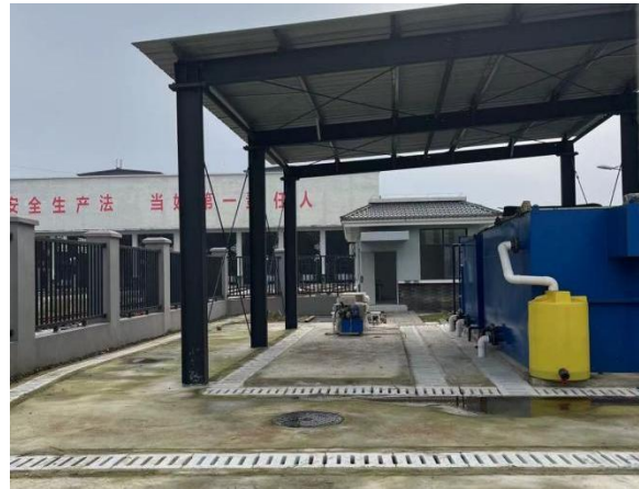
中兴停车场污水处理站
