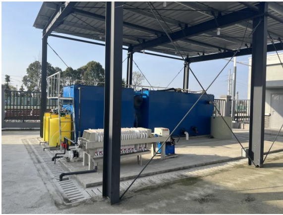
都江堰基地污水处理站
